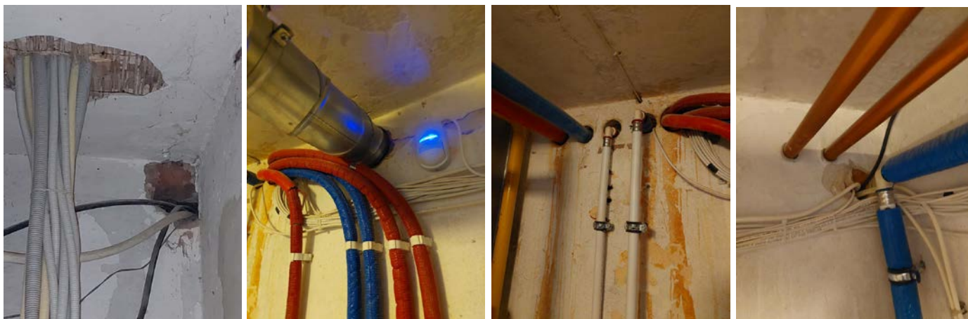
Pilt 7. Tuletõkkekonstruktsiooni läbivad tehnosüsteemid, mis on nõuetekohaselt isoleerimata
