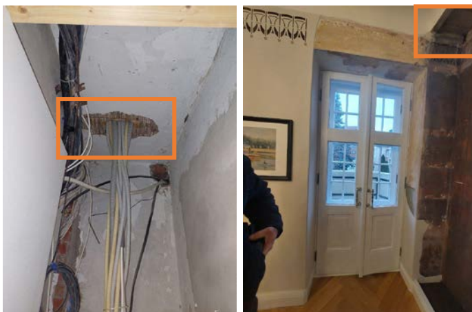
Pilt 2. Keldrikorruse abiruumi ning teise korruse vahelagede osad, kust krohv on maha tulnud
