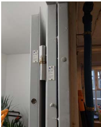
Pilt 4. Keldrikorruse tehnoruumi tuletõkkeukse tähis
